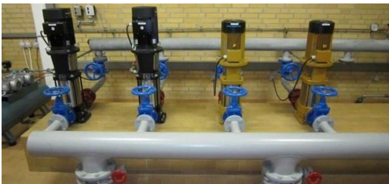
Pumper til levering af vand til forbrugerne
